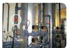
蒸汽管異常溫度偵測
