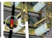
高壓大電纜異常溫度偵測
