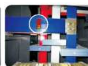
電力匯流排異常溫度偵測
