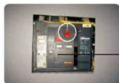
VCB 過載異常溫度偵測
