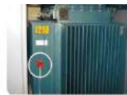
變壓器異常溫度偵測
