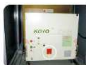
大型 UPS 異常溫度偵測
