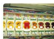
通信環控室異常溫度偵測
