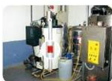
蒸汽管異常溫度偵測
