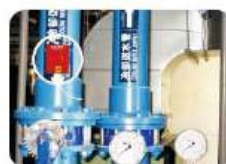
冰水機管路異常溫度偵測
