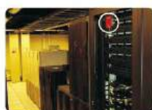
通信機房異常溫度偵測
